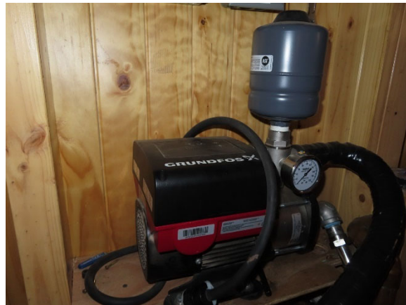
Grundfos Booster Pump
