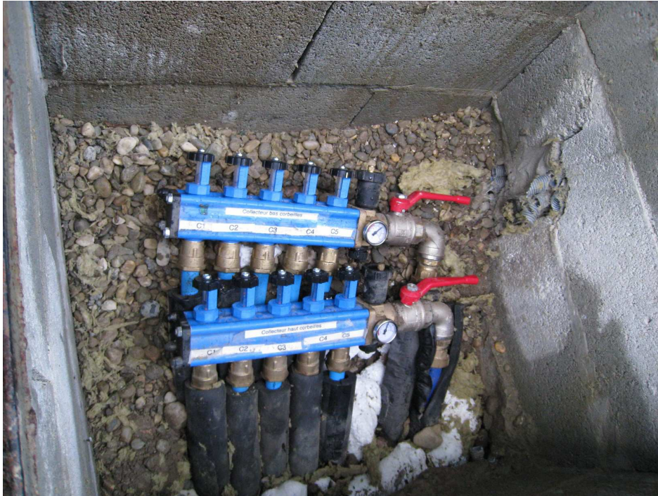
FIGURE 2.4 – Collecteur dans le regard à l’extérieur du bâtiment
