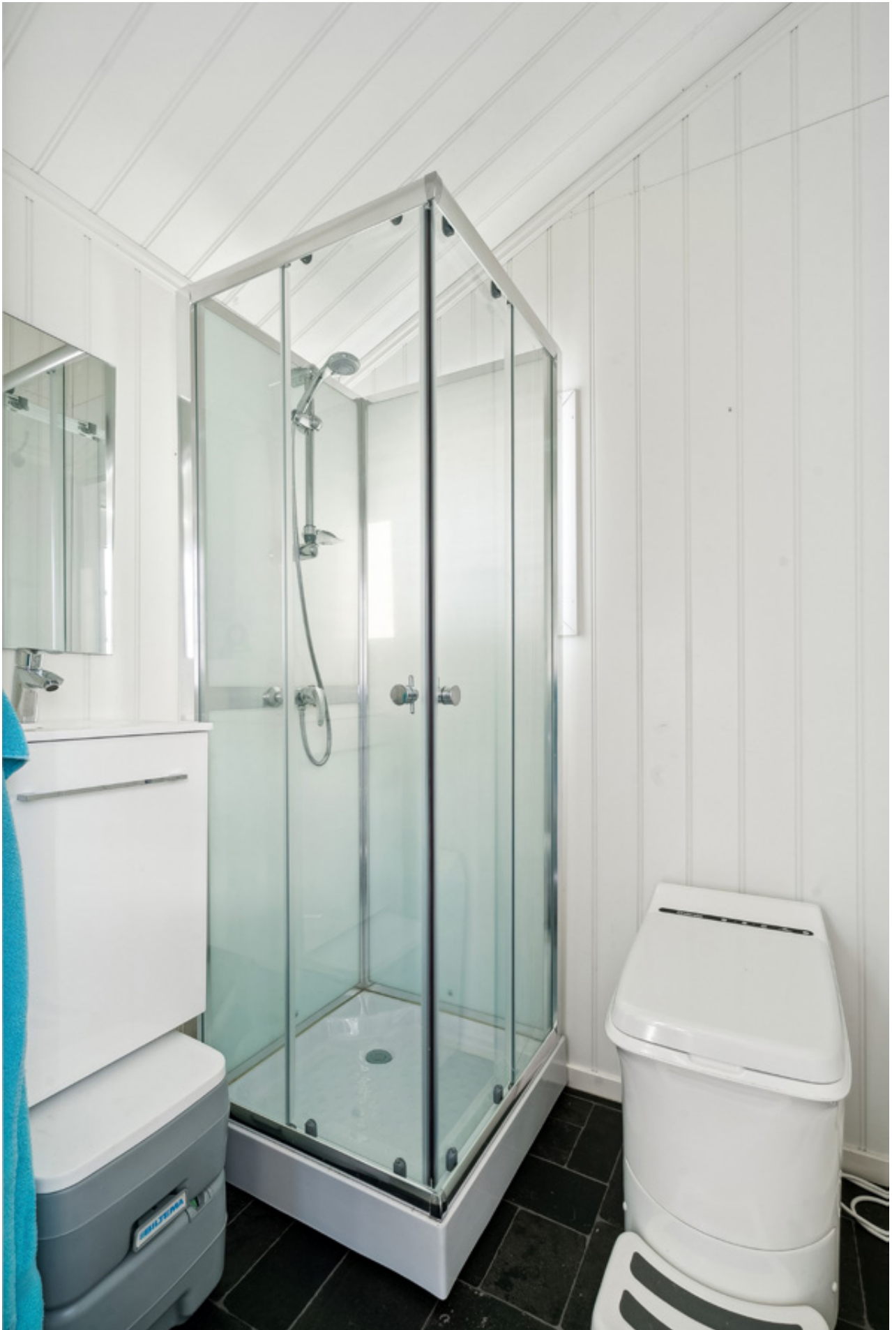
På bad/stellerom" er det montert ett dusjkabinett uten fast vanntilkobling. Elektrisk forbreningstoalett.
